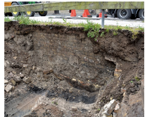
Figur 3. Foto som visar källarväggen längs med Föreningsgatan. Det mörka under väggen är ett dike.
